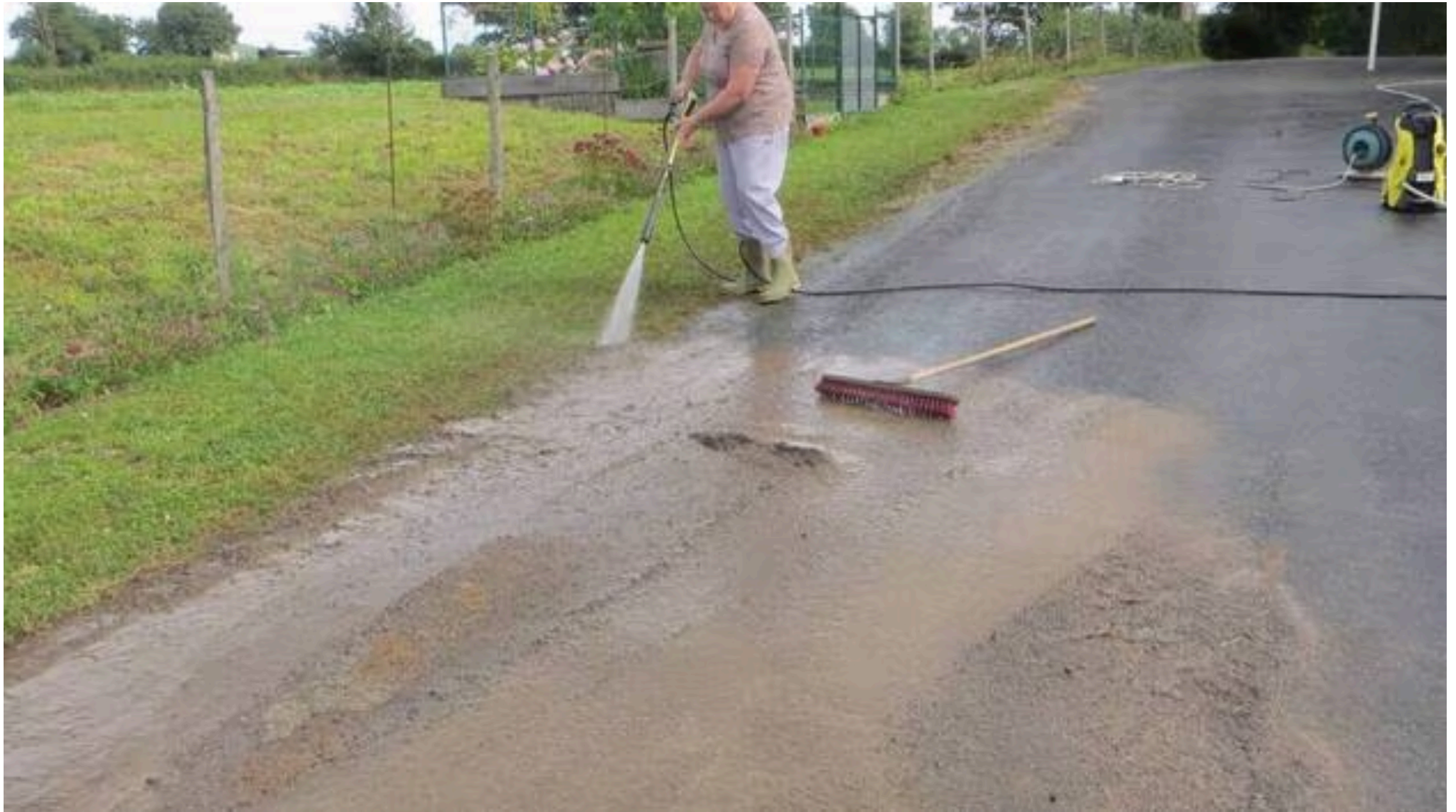
Après chaque passage, c'est la corvée nettoyage. Huile de coude, pelle et eau haute pression. | GASTON BERNARD
